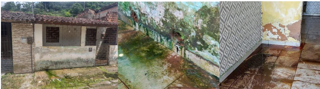
Figura 1: Fotos evidenciando o brotamento de água nas casas da região.
